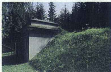
Der Wasserbehälter Nord auf der Gladen
